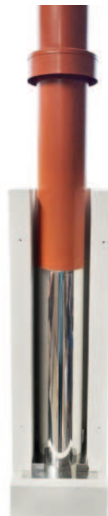
Detailaufnahme Übergang von Leerschacht Porenbeton F90 mit integrierter Abgasleitung PolyStar auf Dachheizzentrale
