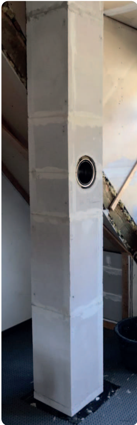
Mehrschalige Abgasanlage Promatec + EW 2.0
