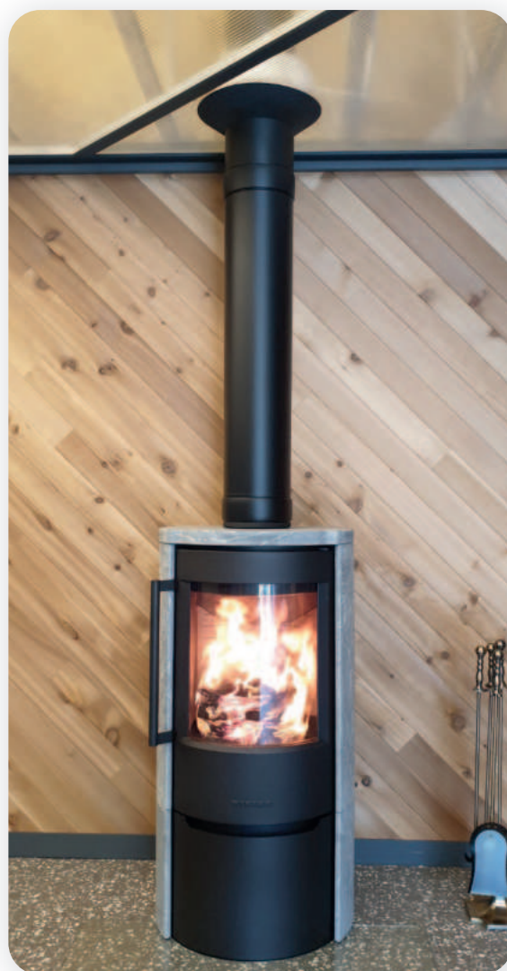
Aufgesetzter Schornstein auf Holzofen mit Deckendurchführung
